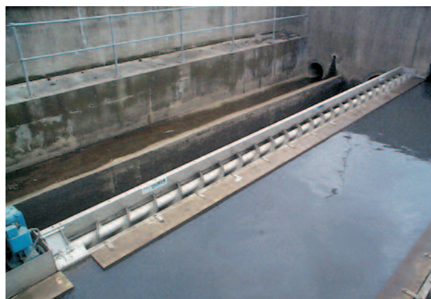
HUBER ROTAMAT® RoK 1 sil installerad i en utmatningstunnel för bräddvatten
