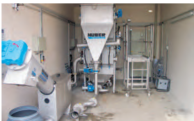
Slakteri Walk / Tyskland: köttbehandling, ROTAMAT® Skruvsil Ro 9 i tank, HUBER Flotationsanläggning HDF-1 utan kemiskt behandlingssteg, genomflöde: upp till 10 m 3 /h
