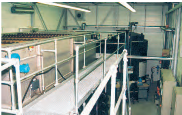
Slakteri Hinwil / Schweiz: ROTAMAT® Siltrumma Ro 2, HUBER Flotationsanläggning HDF-50 med kemiskt behandlingssteg, genomflöde: 50 - 60 m 3 /h, ROTAMAT® Skruvpress RoS 3, genomflöde: 5 m 3 /h
