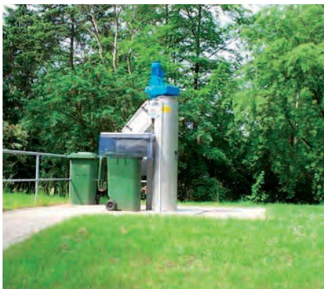
Frostskyddad installation utomhus
