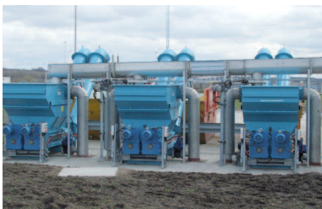
Avloppsreningsverk i Knostrop (Storbritannien) 2 miljoner PE HUBER launderkanal: 20 m 3 avloppsvatten per sekund
