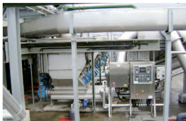
Avloppsreningsverk i Dublin (Irland) 2 miljoner PE HUBER launderkanal: 30 m 3 avloppsvatten per sekund
