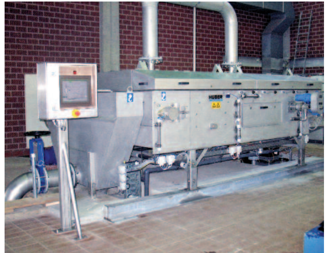
Förtjockningsinstallation för upp till 100 m 3 /h
