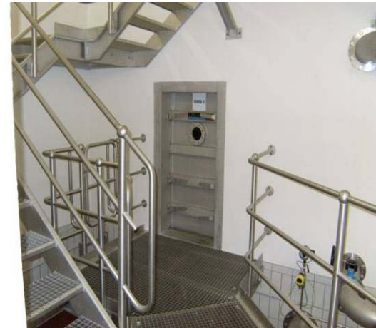
Tryckdörr TT 7 med plattform, räcke och trappor
