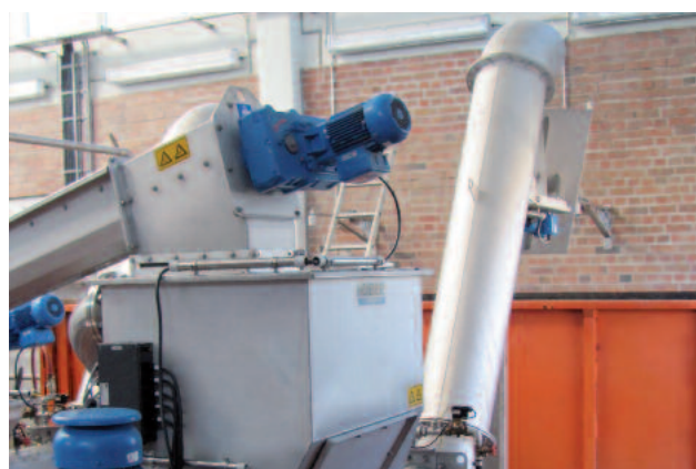
HUBER ROTAMAT® skruvtransportör Ro 8t matar ut rengods till en HUBER tvättpress WAP/SL
