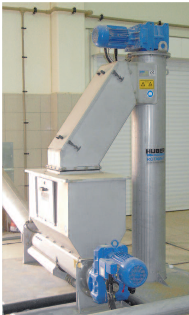
Vertikal installation av en skruvtransportör som matar ut rensods till en HUBER tvättpress.
