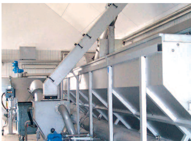
Intensiv tvätt av rensods i en WAP/SL tvättpress efter en ROTAMAT® kompaktanläggning Ro 5
